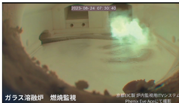
写真 1 Phoenix Eye “Ace” による炉内監視画像
