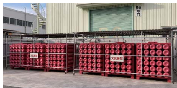
写真2 水素カードル
