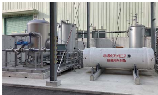
写真3 液化アンモニアボンベ
